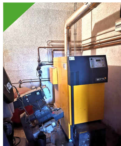
Chaudière ETA 35 KW
